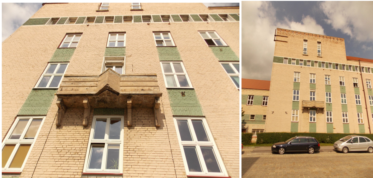
Fot 5, Fot 6. Elewacje zewnętrzne do renowacji (oczyszczenia z farby), ocieplenia od wewnątrz
